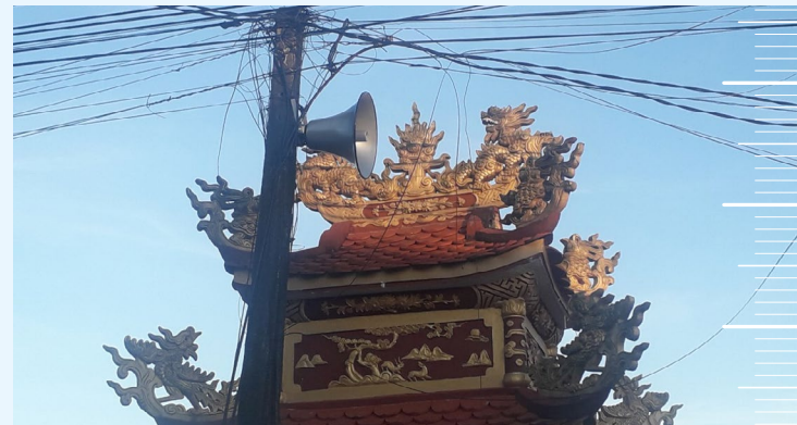
Cụm loa truyền thanh do dự án FRMC hỗ trợ nhằm cải thiện công tác truyền tin cảnh báo lũ sớm tại thôn Phò Nam A, xã Quảng Thọ, huyện Quảng Điền, tỉnh Thừa Thiên Huế. Ảnh: BCH PCTT TTH
