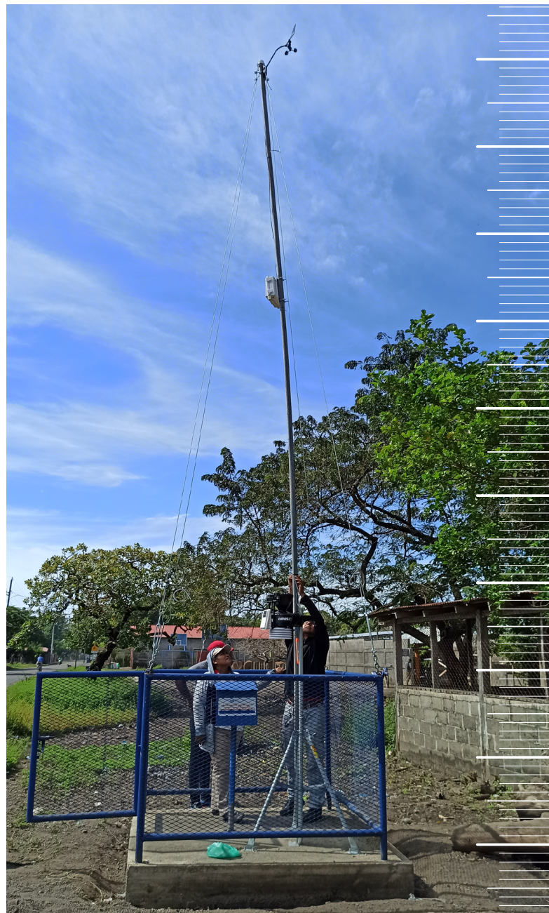
El equipo técnico de INETER instalando la nueva estación meteorológica comunal en Mechapa, Chinandega, Nicaragua © Felix Rugama, Plan Internacional
