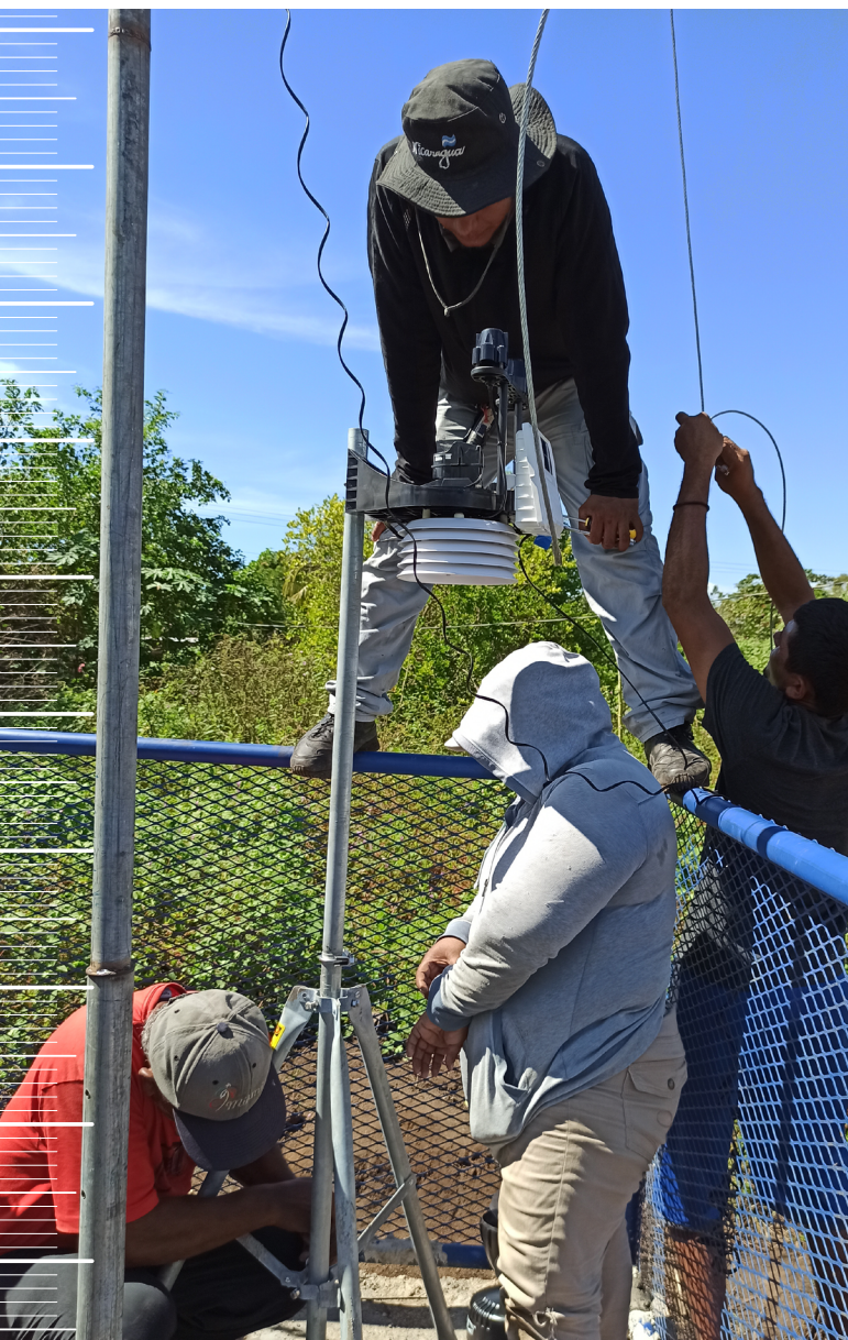
El equipo técnico de INETER instalando la nueva estación meteorológica comunal en Mechapa, Chinandega, Nicaragua, noviembre de 2020 © Felix Rugama, Plan Internacional
